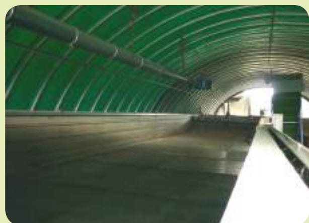
Séchoir caisson sous tunnel
